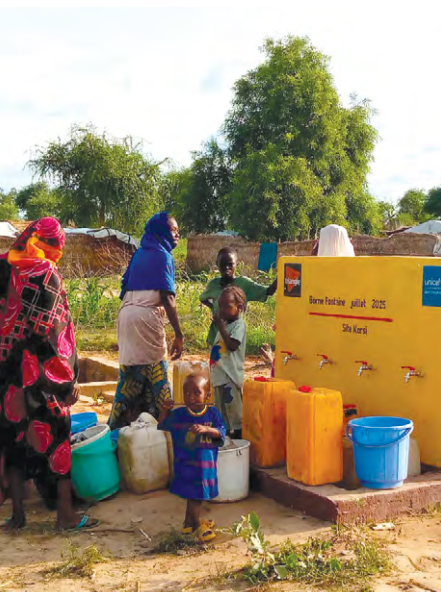
Borne fontaine d'eau potable installée sur le site d'accueil de réfugiés de Korsi en Vakaga, 2025. © TGH
