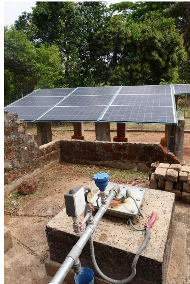
Pompage solaire - Guinée
